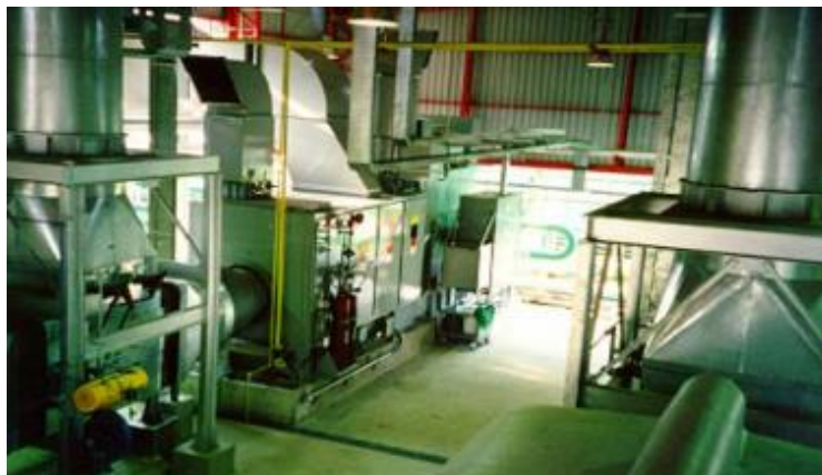
Figura 3.7 - Cogeração Ciclo Brayton – Heineken, Jacareí, SP
